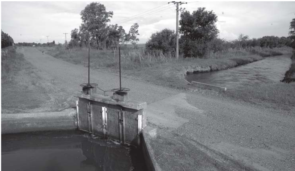
Canalización de Calagua
